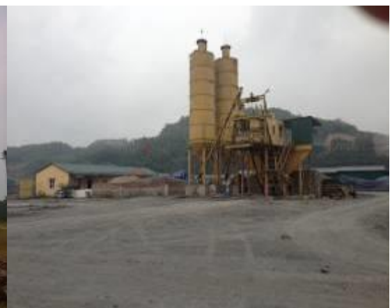
Trạm trộn bê tông IMI 80
